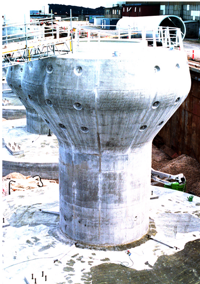
Betongfundament som använts vid Middelgrunden. Foto: Göte Niklasson
